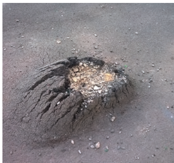
Деревянная свая выталкивается из вечномёрзлых грунтов даже сквозь асфальт
